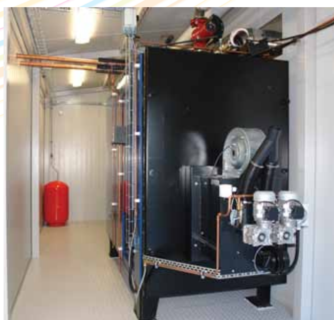
Värmemodul 500 kW. Samtliga värmemoduler är driftsatta och testkörda innan leverans.
