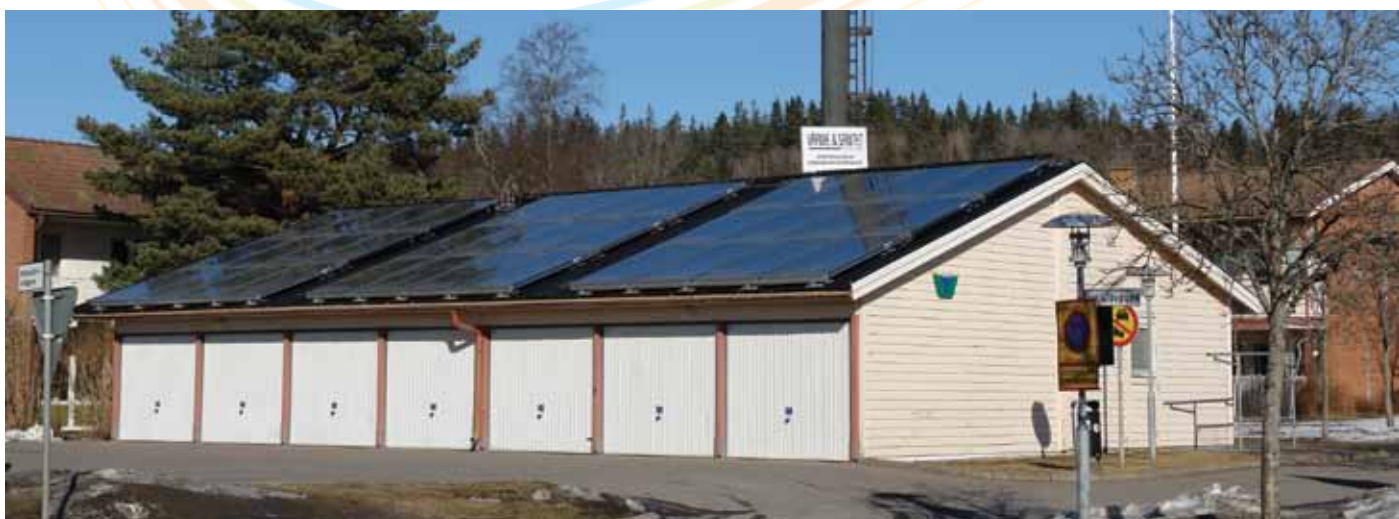
Tenhult, 300kW pelletsanläggning samt 72 st plana solfångare. Läs mer om anläggningen på sidan 10.
